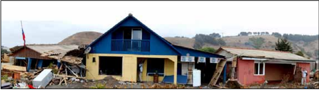
Figura 2-3: Falla de diferentes tipologías estructurales en Iloca, VII Región.*
