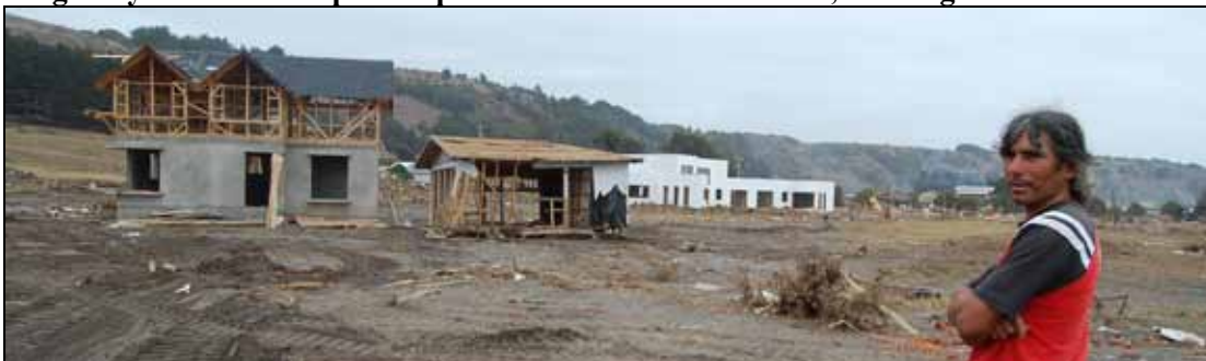
Figura 2-9: Restos del segundo piso de una vivienda de madera desplazada desde su posición original y vivienda con primer piso en construcción en Iloca, VII Región.
