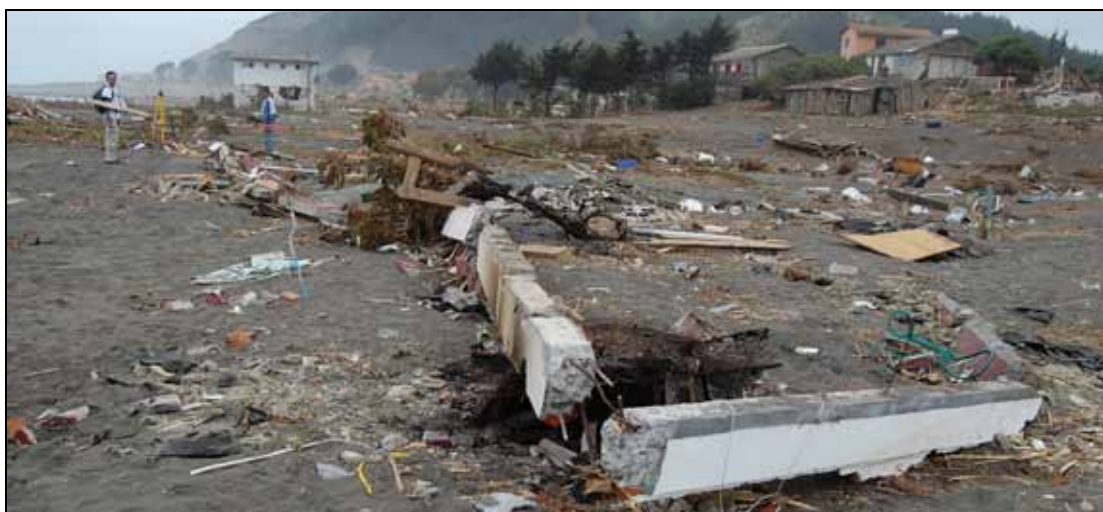
Figura 2-8: Cadenas de vivienda encontradas a decenas de metros de su posición original (al fondo) en Iloca, VII Región.
