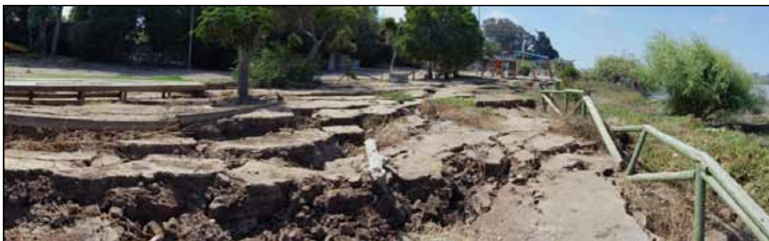
Figura 2-15: Falla de suelo en la ribera del Río Maipo, V Región.
