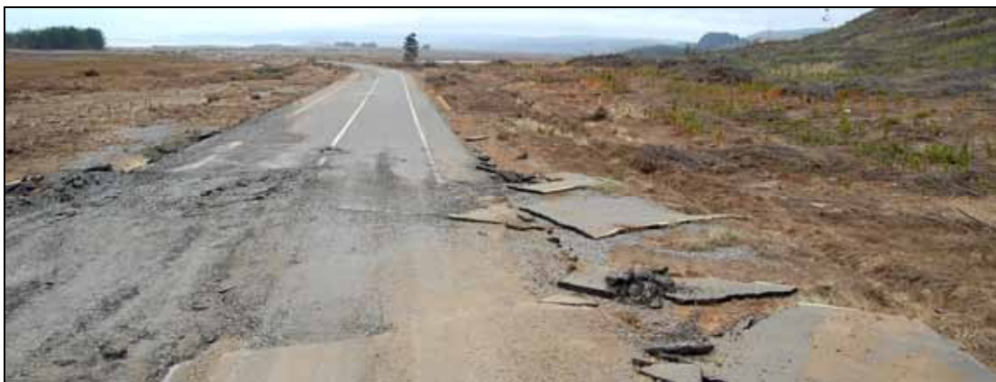
Figura 2-13: Falla del camino costero en La Trinchera, VII Región.
