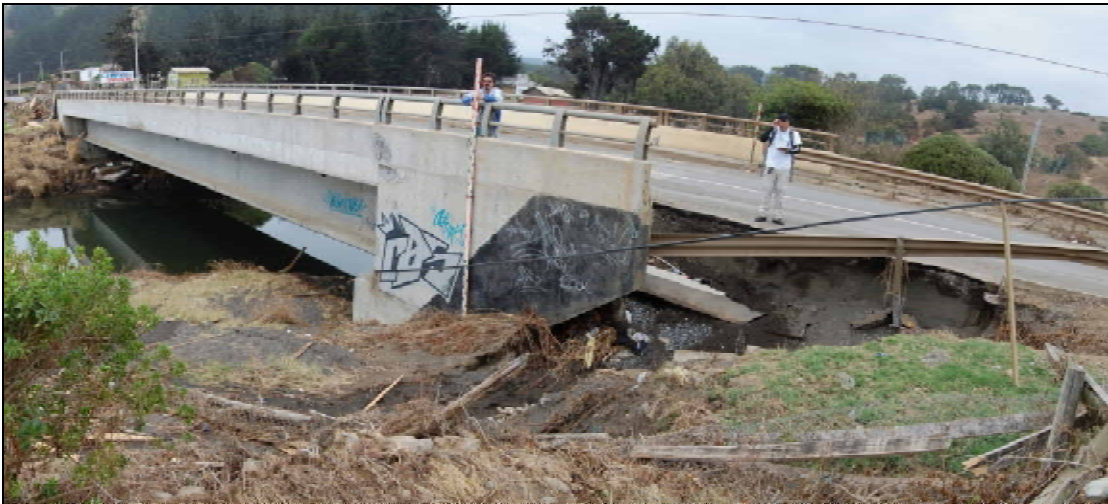
Figura 2-2: Falla por socavación del estribo del Puente Iloca, VII Región.
